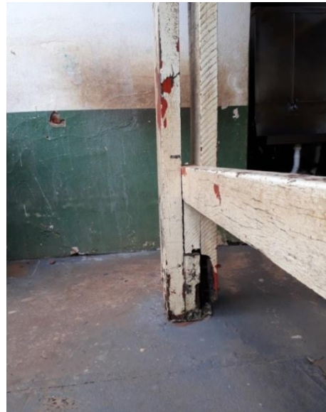
Viga de madeira que sustenta uma das coberturas da área do pátio da escola Maria Julião encontrada estragada, necessitando de reparo urgente (Foto 1 – Viga).
