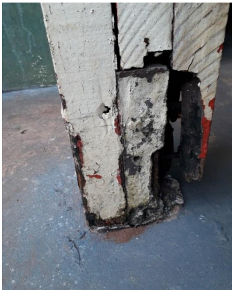
Viga de madeira da escola Maria Julião (Foto 2).
