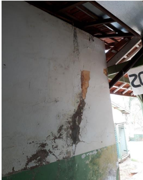
Parede lateral da cozinha (local onde é preparada merenda) da escola Maria Julião apresenta marcas de infiltração e pintura descascada.
