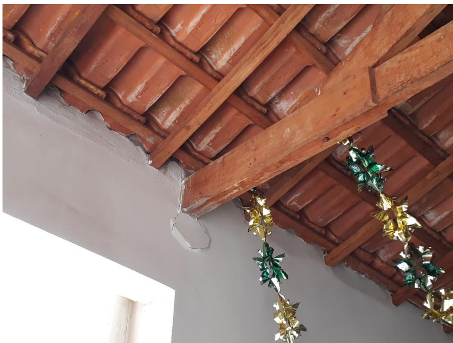
Creche municipal localizada na Av. Cel. Eduardo de Souza Porto: telhado do pátio apresenta problemas na estrutura de sustentação (Foto nº 2).
