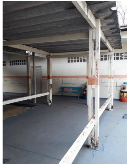
Viga de madeira da escola Maria Julião (Foto 3).
